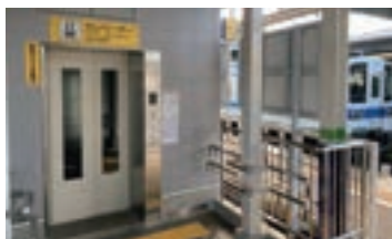
エレベーター
