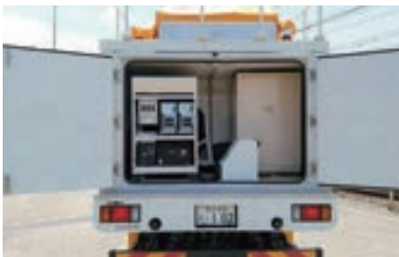
電気検測車に搭載された機器
