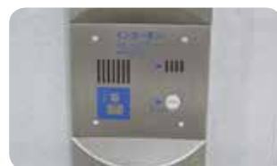
非常用インターホン
